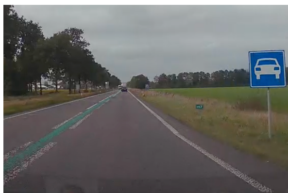
Afb. 8: Vervaaagde markering nabij aansluiting Gasselte
