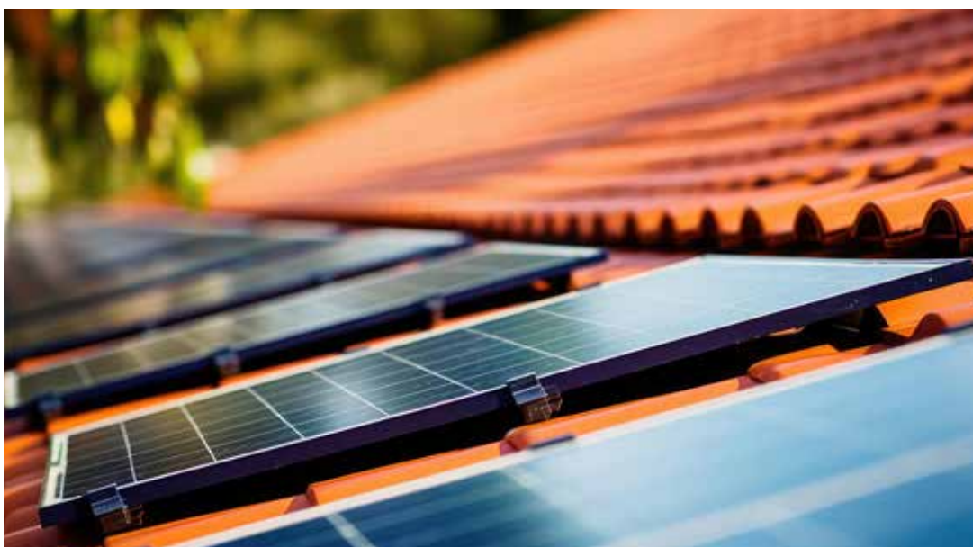
Zonnepanelen op dak (cherezoff, Adobe Stock)
