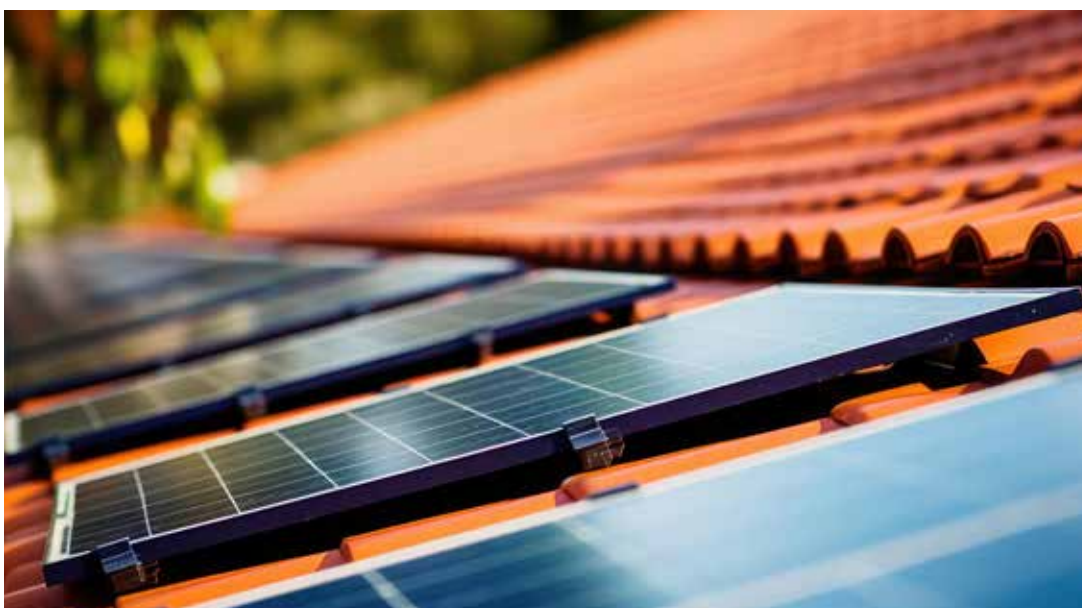
Zonnepanelen op dak (cherezoff, Adobe Stock)
